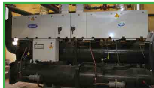
Carrier värmepump 30HXC "Global Chiller" placerad i maskinrummet hos Tågerups Trädgård.
